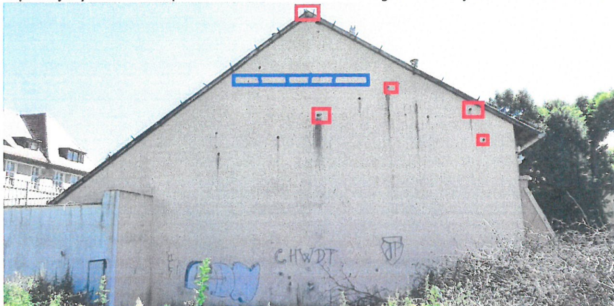
Fot. 22, 23. Ściana zachodnia budynku sali gimnastycznej z zaznaczonymi na czerwono siedliskami i potencjalnymi siedliskami ptaków. Na niebiesko zaznaczono sugerowane miejsce zawieszenia budek.
