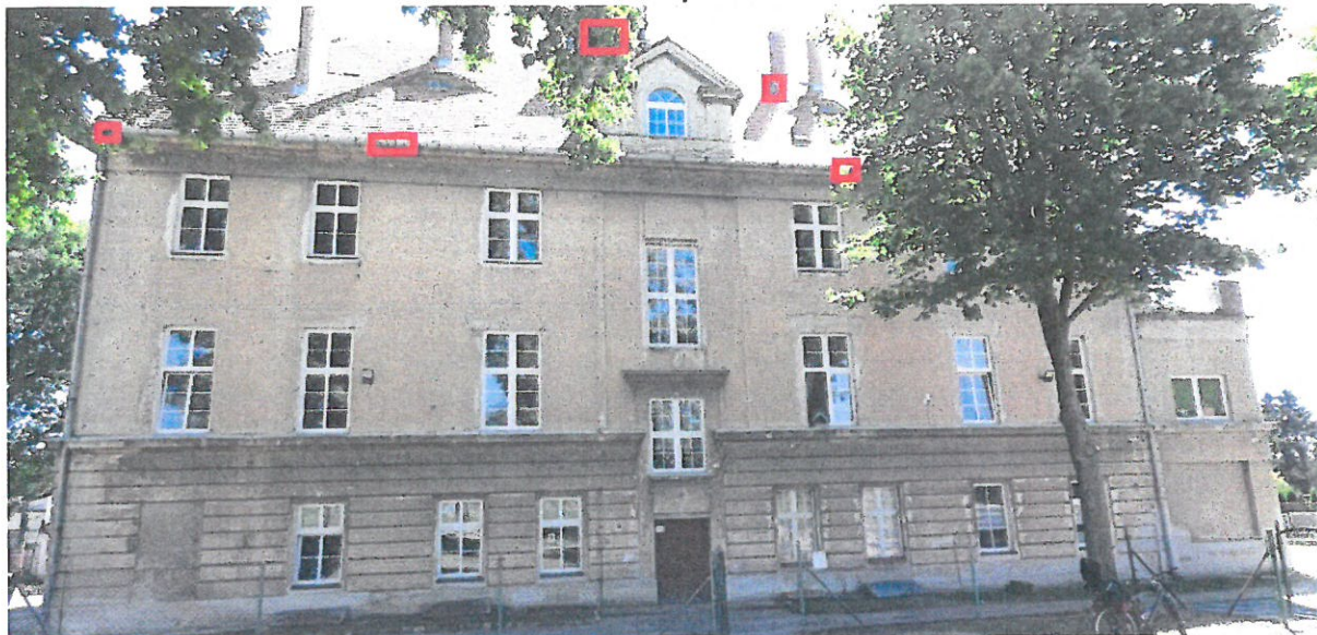
Fot. 13, 14. Ściana zachodnia budynku szkoły z zaznaczonymi na czerwono siedliskami i potencjalnymi siedliskami ptaków.
