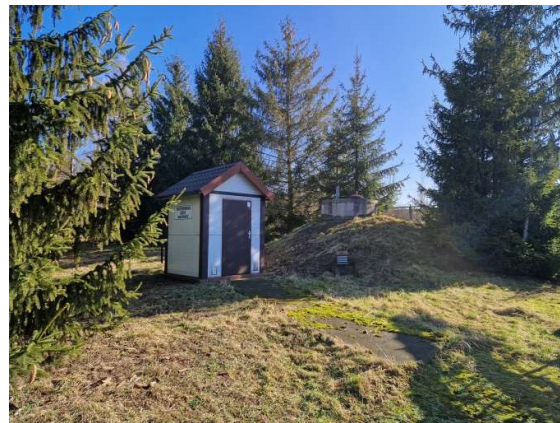
Działająca pompownia wody do wsi Koziniec
