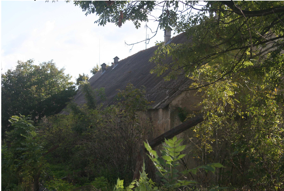
Rysunek 3.7 Przykład obiektu na którym stwierdzono zły stan techniczny wyrobów azbestowych
