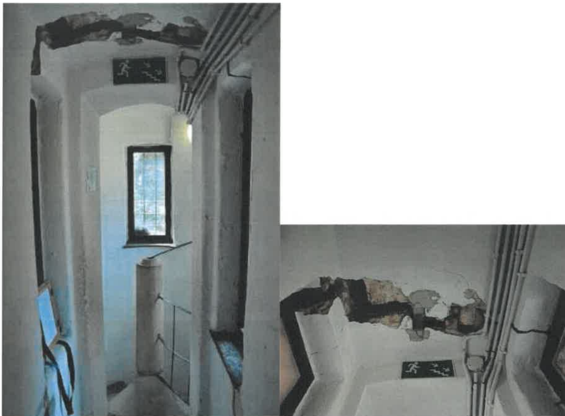
Fot. nr 3. Uszkodzenia wewnętrzne – przejście z klatki schodowej do wieży.
