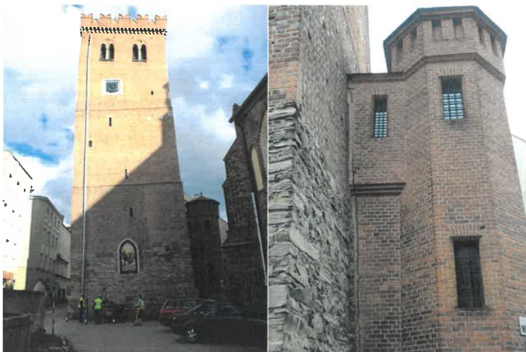
Fot. nr 1. Widok ogólny wieży i przybudówki oraz pęknięcie na styku obu konstrukcji.
